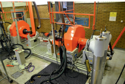
Rum med provrigg för komplett motoraggregat för tester efter genomförd renovering/reparation.
